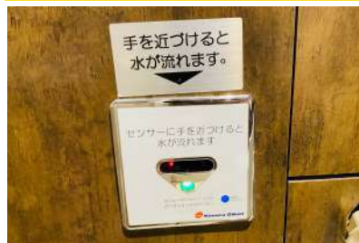
トイレの洗浄センサー
